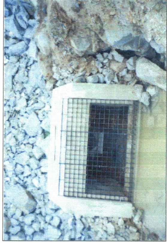
FOTO Nº 07 - Caixa de entrada da tomada d'água, com grade de proteção.
